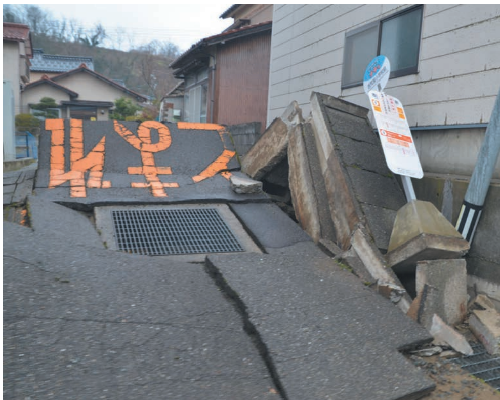
内灘町西荒屋では道路が1メートル以上めくれ上がり通行不能になっていた
