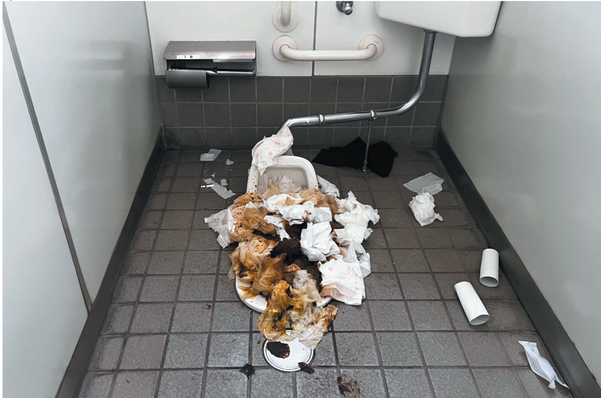
「道の駅すずなり」の男性トイレ。この後、使用禁止になった(2024年1月14日、珠洲市で撮影)
